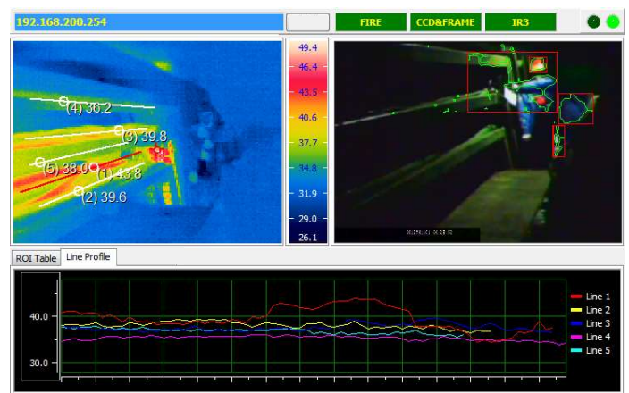
鉄鋼会社のケーブルルームの火災監視
